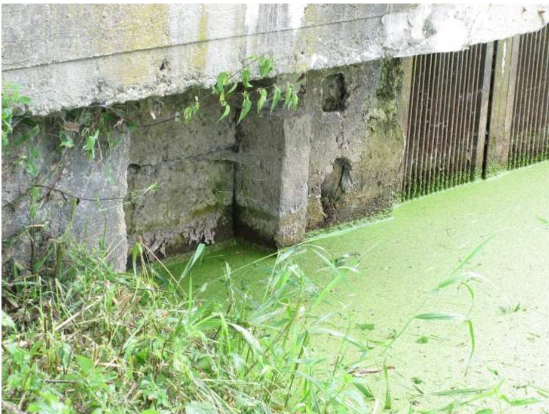
Fot. 18 Pompownia nr 2 -Stan betonów od strony wlotu do komory czerpnej.
