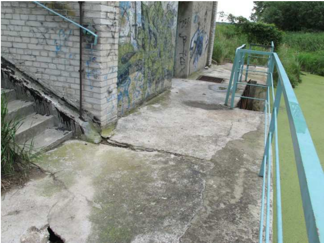
Fot. 9 Pompownia nr 1
