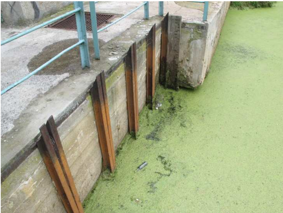
Fot. 10 Pompownia nr 1
